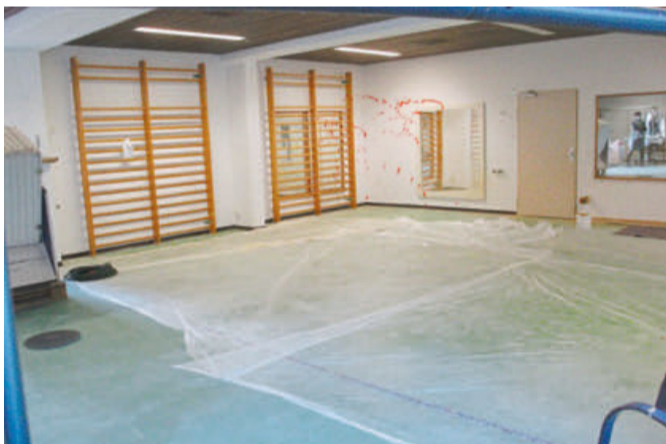
Der Gymnastikraum im Untergeschoss befindet sich in der Renovierung. 400.000 Euro will der Eigentümer für die Sanierung insgesamt investieren. Foto: Lydia Böhne
